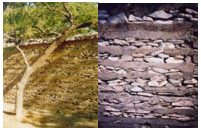
Sistema tibetano: construcción de tierra apisonada, capas de piedras y tierra. Esta técnica consiste en dos tercios de piedra y un tercio de arena y barro.
